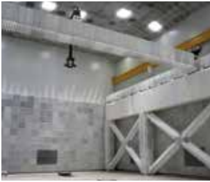
En el "scanner" se mide la performance de la antena de comunicaciones del satélite de forma tal que desde 36.000 km. transmita correctamente.
